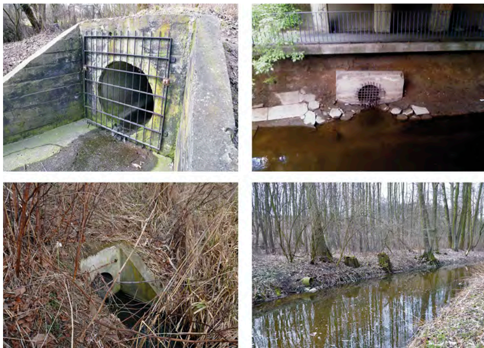
Fot. 120. Wyloty kolektorów odprowadzających wody deszczowe do Cybiny
